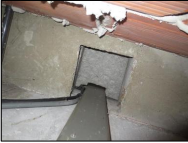
Photo N° 1141 AMIANTE CIMENT -- placards technique rdc à +9 Planchers Plaques planes (Fibres- ciment)
